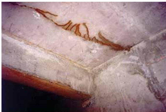
Figura 16 - Problemas na estrutura de concreto provocados por infiltrações
